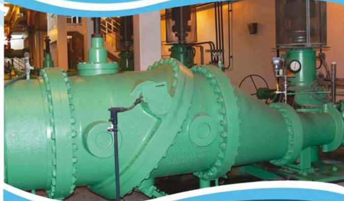
Effluent Pump Discharge Check Valve
